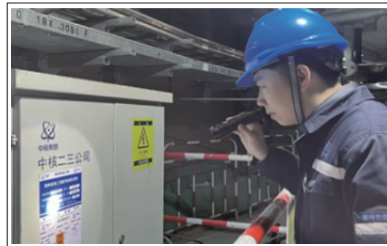
田大勇在1号核岛内临时配电箱检查
