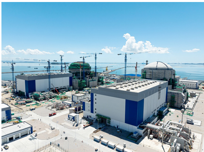
漳州核电2号机组首台柴油发电机组首启成功
