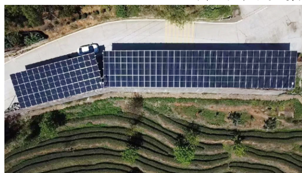
光伏景观长廊顶上的光伏板不仅可以为周边用电设备提供清洁电能，还能作为遮阳设施使用。
