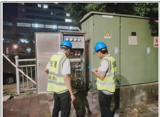
技术团队全面排查电压稳定性与线路健康状况
